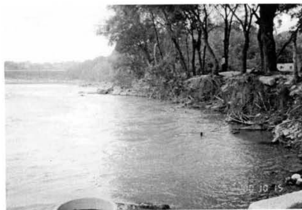
水制工が崩壊し付近の遠浅上の水辺が断崖上になった
