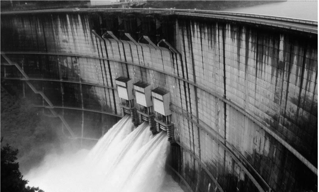
2011年9月21日、矢作ダムは諸規模の洪水放流中だった。最上段4門の非常用洪水ゲートは閉鎖。夏期制限水位EL292mを守るため、下段3門の常用洪水ゲートを開閉しては水位調整をしている風景だ。〔1・3面写真：矢作ダム管理所提供〕
