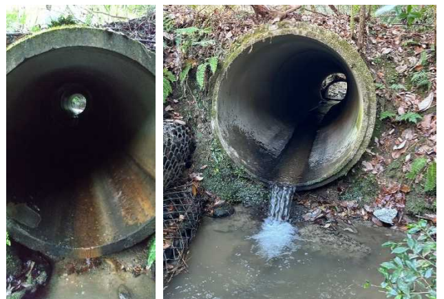
写真 2 吉田川 コンクリート製パイプカルバート (左・下流側 右・上流側)
