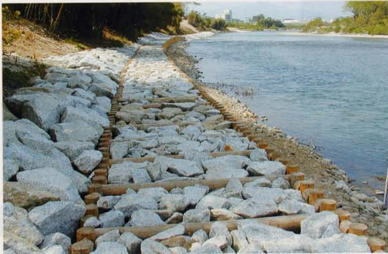
破碎岩でつくった水辺の遊歩道。危なくて高齢者は歩けない
