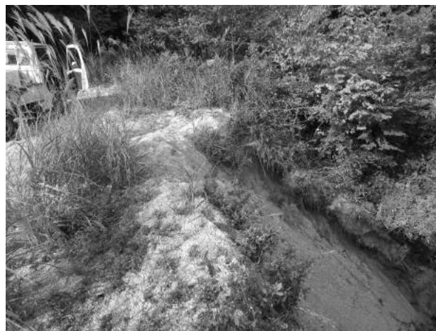
写真4 飯田洞川間野地区周辺の林道脇の斜面崩壊 2013年10月2日筆者撮影
